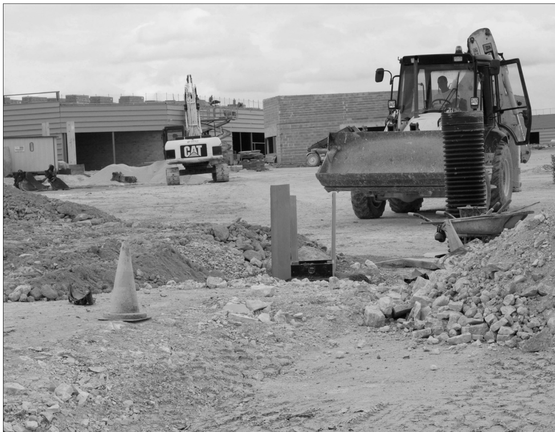
L'ouverture de la zone commerciale, en chantier, est prévue en avril 2013. PHOTO TADEUSZ KLUBA/« SUD OUEST »
